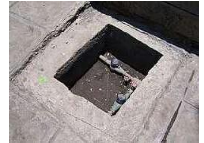
Compteurs d'eau, coffrets techniques non étanches
